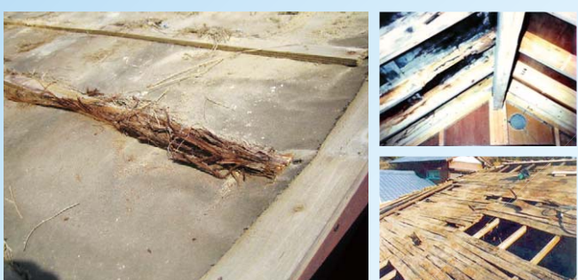
腐朽した木材や合板
