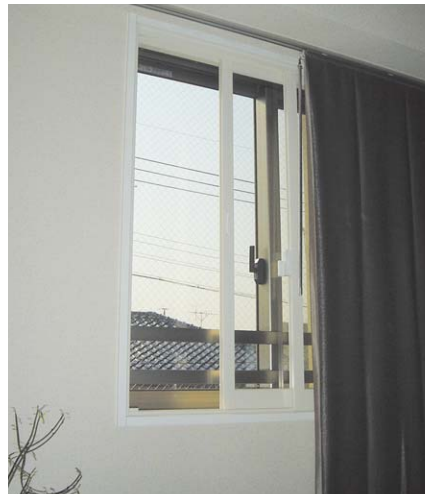
洋室 / 結露でカーテンを汚したくないお部屋にも
